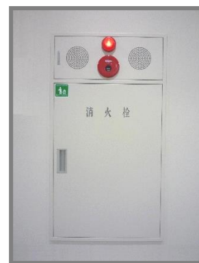
火災報知器&消火栓
