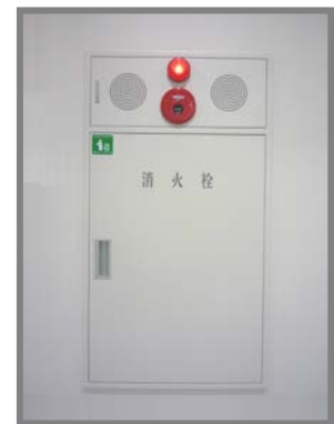
火災報知器&消火栓
