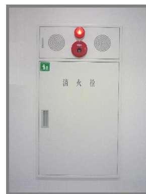
火災報知器 & 消火栓
