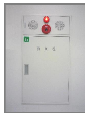
火災報知器&消火栓
