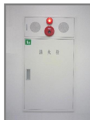
火災報知器&消火栓
