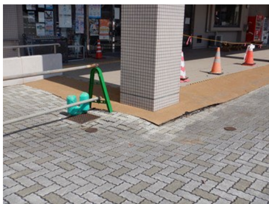
写真 1 地盤沈下による舗装の被害
