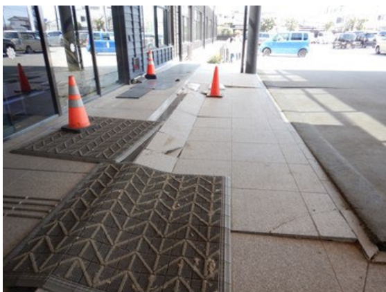
写真 3 相馬市役所入り口前の舗装の被害
