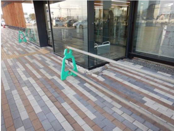
写真 23 地盤沈下による舗装の被害
