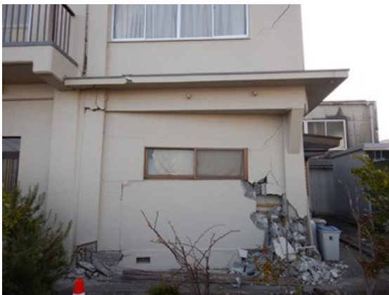
写真 25 RC 造建物の外壁と柱の被害
