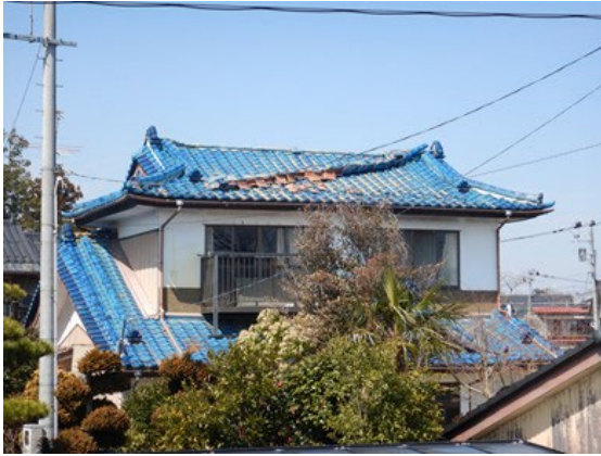
写真 5 瓦屋根の被害
