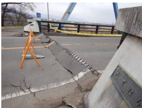
写真 34 伊達橋の接続部分の変形
