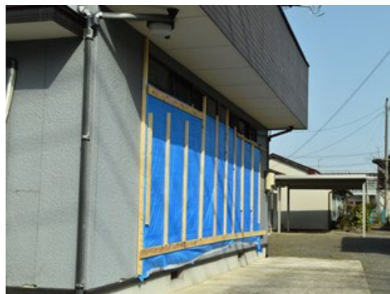
写真 18 住宅の窓の被害
