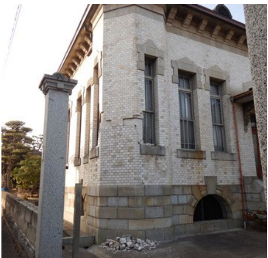
写真 27 外壁の被害（奥山家住宅洋館）
