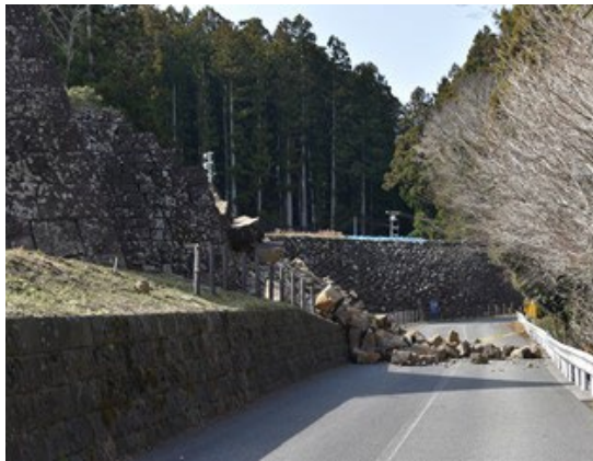
写真 15 仙台城の石垣の崩落
