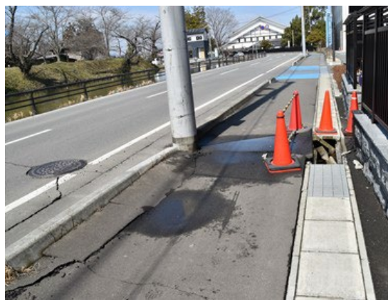
写真 4 周囲の歩道の被害
