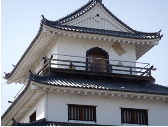
写真 19 白石城天守閣の外壁の被害
