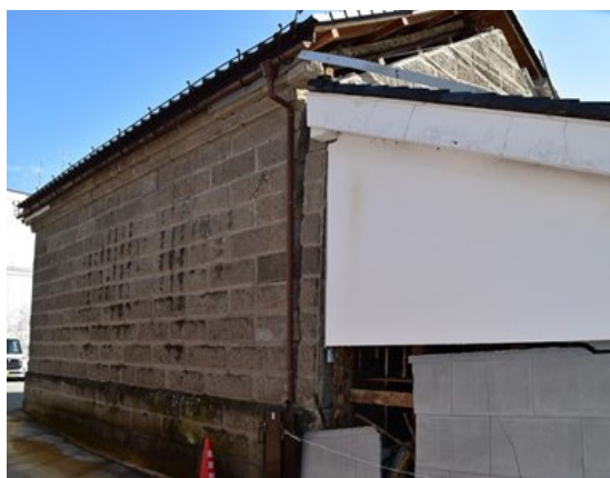
写真 11 組積造建物の被害
