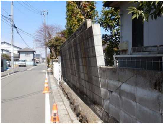
写真 7 ブロック塀の被害
