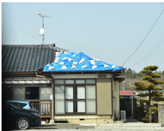
写真 17 瓦屋根の被害
