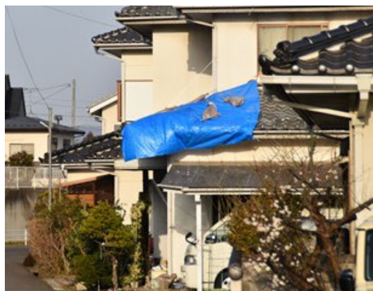
写真 30 瓦屋根の被害
